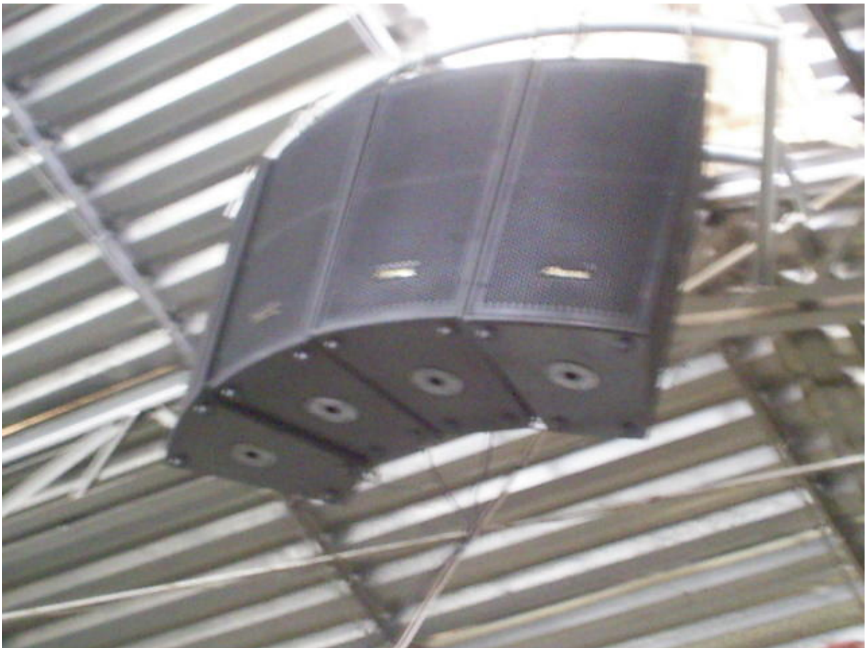
Cluster que utiliza caixas de 2 vias (woofer + driver titânio). As caixas são instaladas bem junto, de forma a soarem como uma só, abrangendo toda a largura da igreja.
